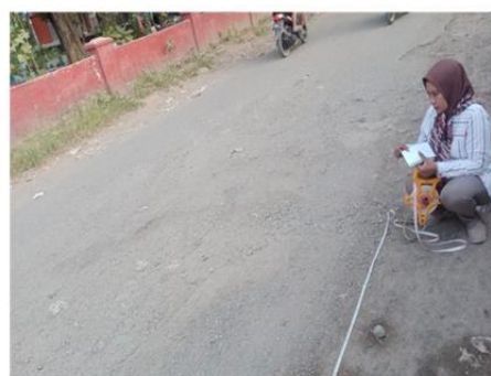
FOTO JENIS KERUSAKAN LUBANG
