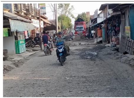
FOTO JENIS KERUSAKAN PELEPASAN BUTIR
