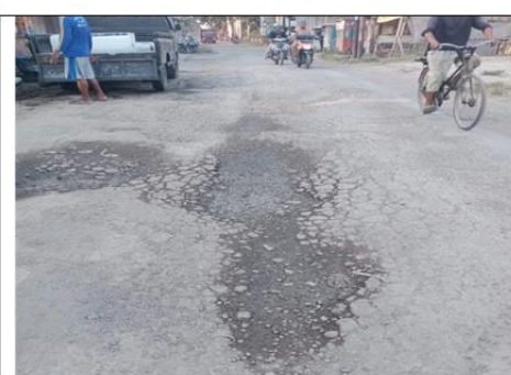
FOTO JENIS KERUSAKAN LUBANG
