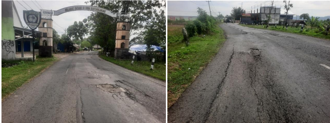
Gambar 1. Dokumentasi Kerusakan Jalan
